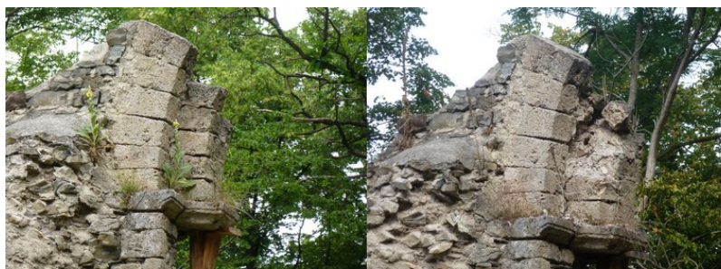
Ci dessus état constaté le 14/09/13
